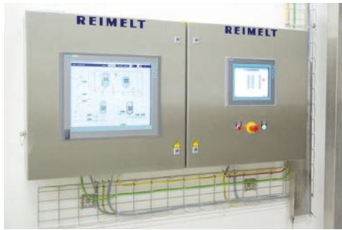
Steuerung des Codos-Systems und der angeschlossenen Verwiegung. Der gesamte Komplex lässt sich grafisch darstellen.
