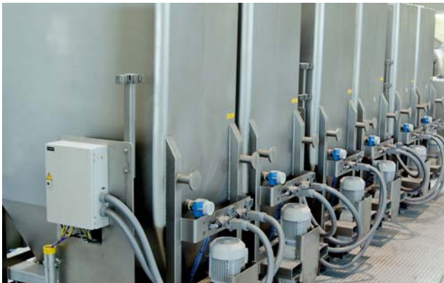
Wechselcontainer mit Austragsorganen auf den Dosierpositionen
