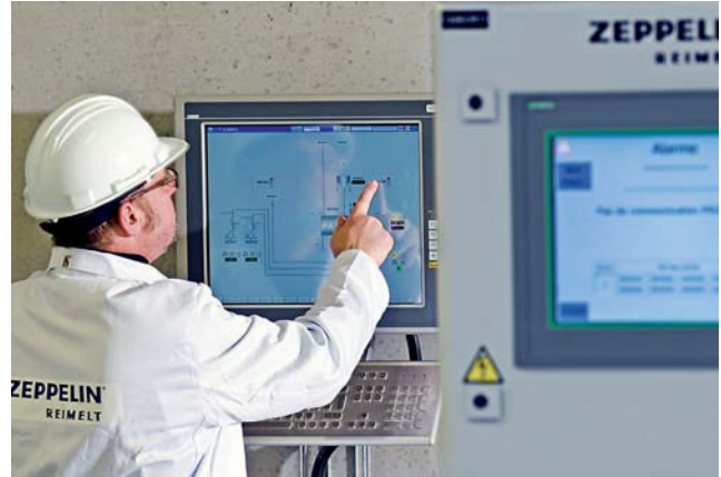
Bedien- und Kontrollterminals direkt im Feld der Anlage
