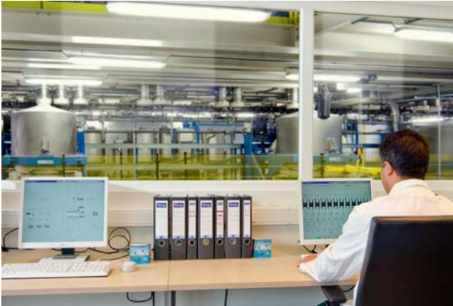
Schaltwarte zur Anlagensteuerung und Überblick
