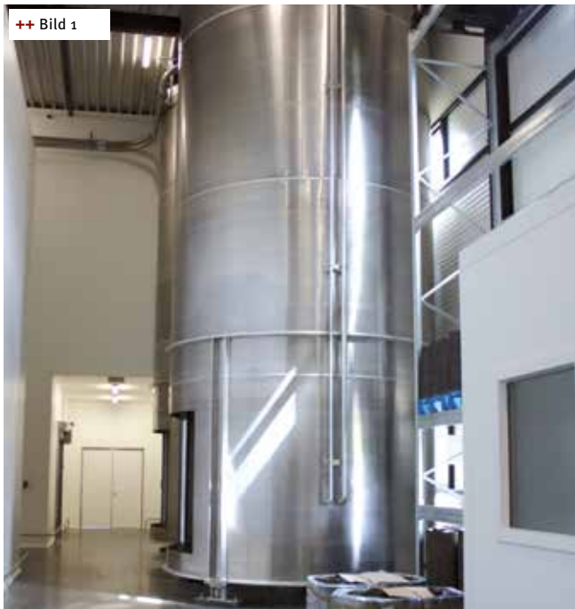
++ Bild 1 Zeppelin Systems lieferte neben dem Batchmanagementsystem auch die Anlagen für das Rohstoff-Handling. Dazu gehören auch die beiden Innensilos mit je 35 t Fassungsvermögen für den Zucker und das Mehl
