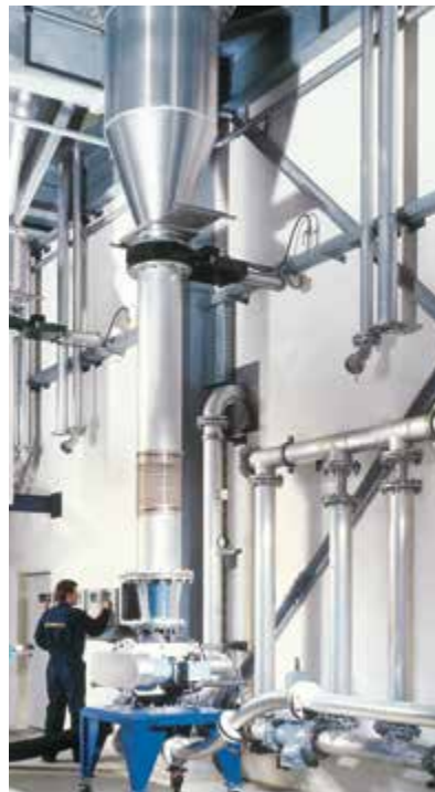
Granulatförderung mit einer Zellenradschleuse unter einem Mischsilo.
